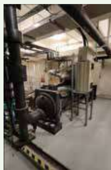
總部冰水主機增設變頻
