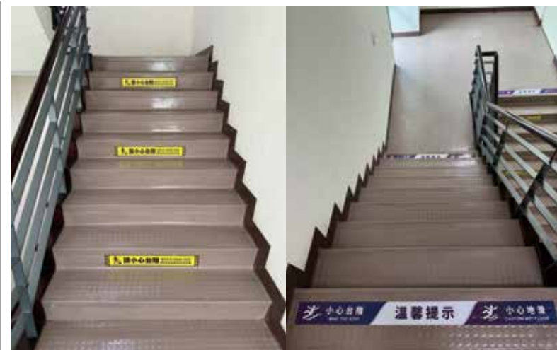
未黏貼地面安全標示
