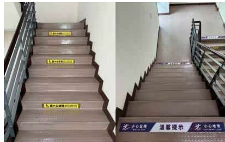
未黏貼地面安全標示
