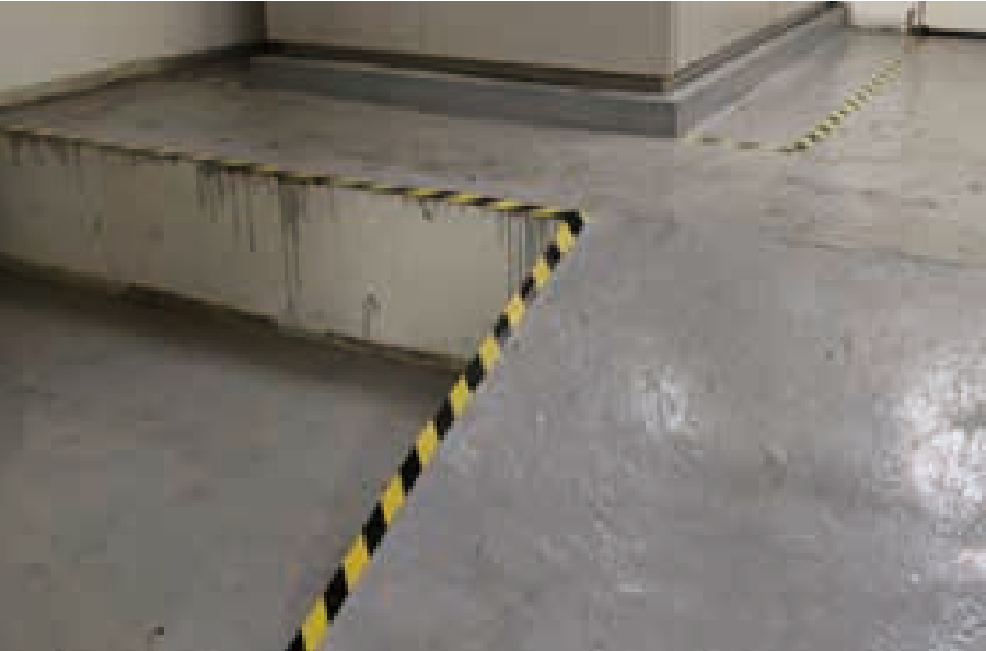
▼ 改善方案一：上下階梯無安全防護
